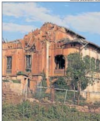
Imatge de la degradada torre Lluvià
